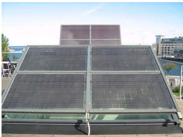
Солнечная батарея на крыше офисе энергетического агентства региона Сконе
