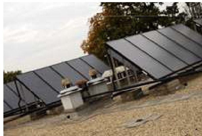
Napkollektoros rendszer Deszk Mellkasi Betegségek Szakkórháza
